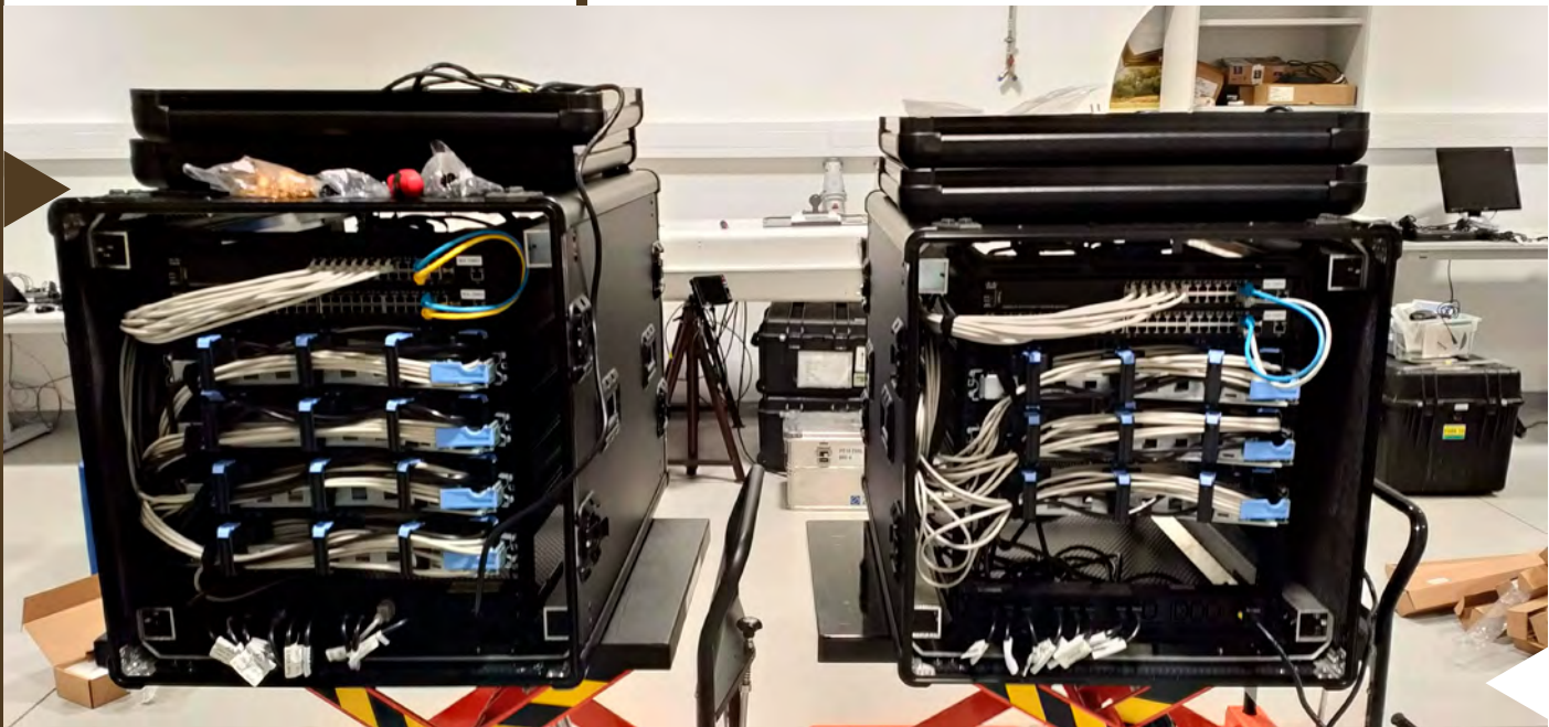
► Vista trasera de los servidores para la zona de trabajo y la zona de recepción.
